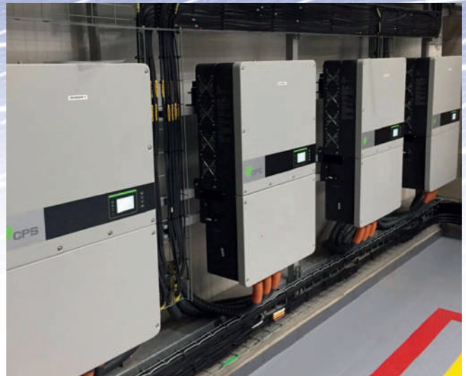
CPS 206.4 kWp - Proyecto Ventanar - Colombia
